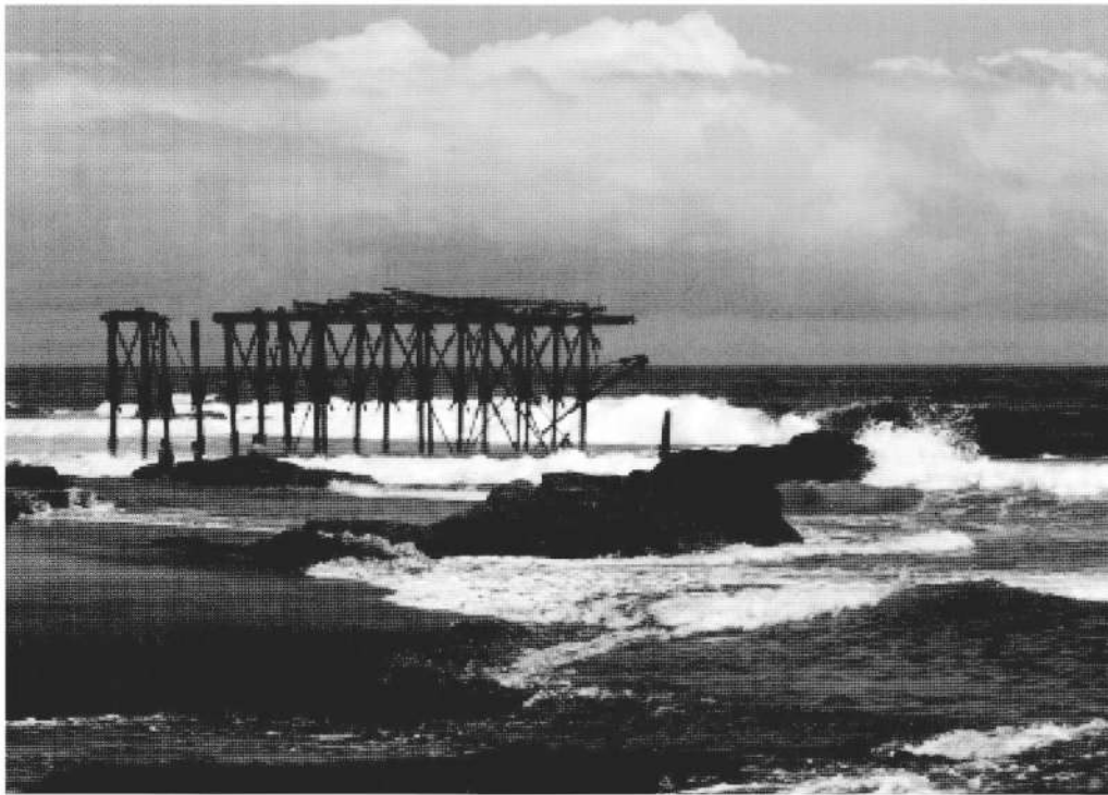
Dos vistas del antiguo puerto de Llico, construido en 1893 y hoy casi destruido por acción de las aguas del mar.
